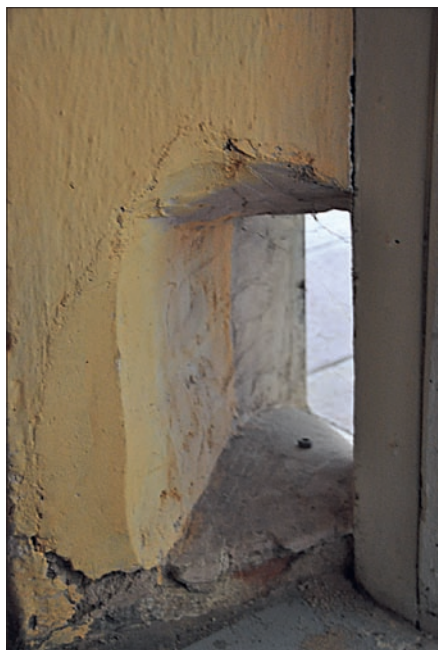
Obr. 29: Františkovy Lázně, dům čp. 9, prostup zdí těsně vedle vstupu do kuchyně ve druhém patře, zřejmě pro přívod vody pro kotel (foto L. Zeman, 2017).
